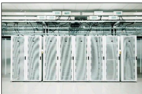
I de här skåpen staplas kundernas servrar, och varje hall innehåller mängder med skåp när hallen är fullt utbyggd. Foto: EcoDataCenter
