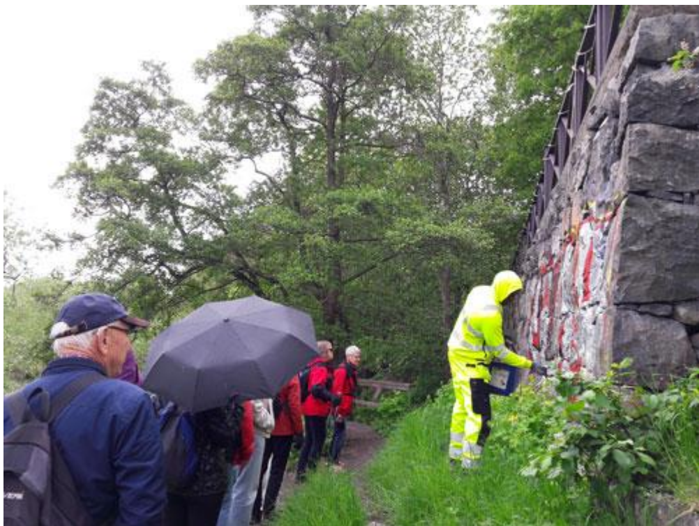
På väg från Karlhälls gård kom vi förbi ett arbetslag som höll på att ta bort klotter på en mur.
